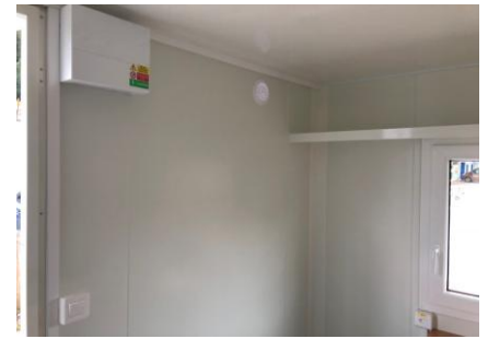
Sicherungskasten rechts neben Türe
