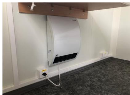
Elektroheizung unter Tisch
