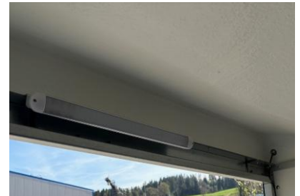
LED Lampe über Türrahmen
