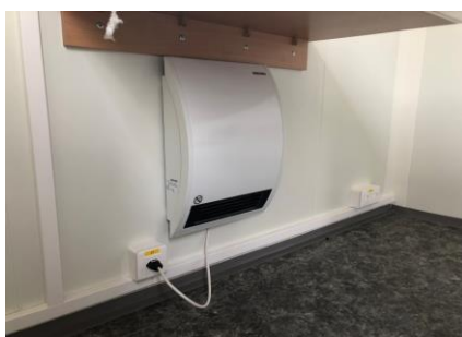
Elektroheizung unter Tisch
