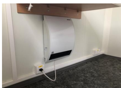
Elektroheizung unter Tisch
